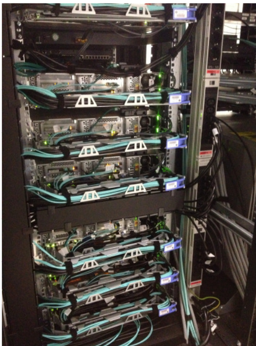
C / VEKA Rechenzentrum, 2013
