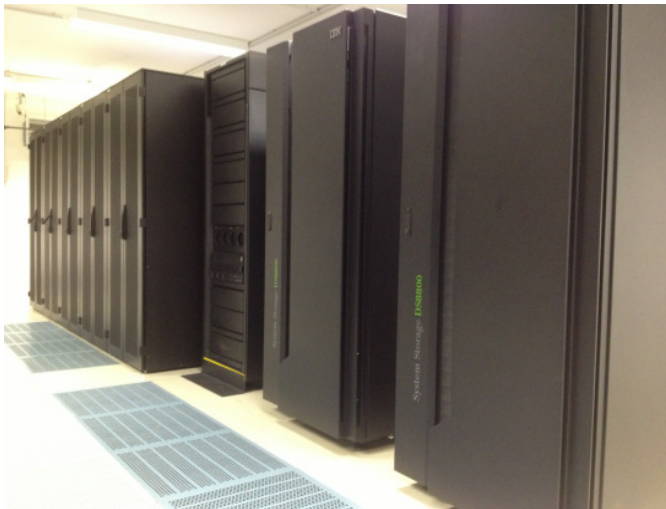
C / VEKA Rechenzentrum, 2013
