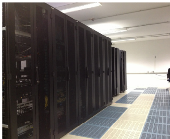
C / VEKA Rechenzentrum, 2013
