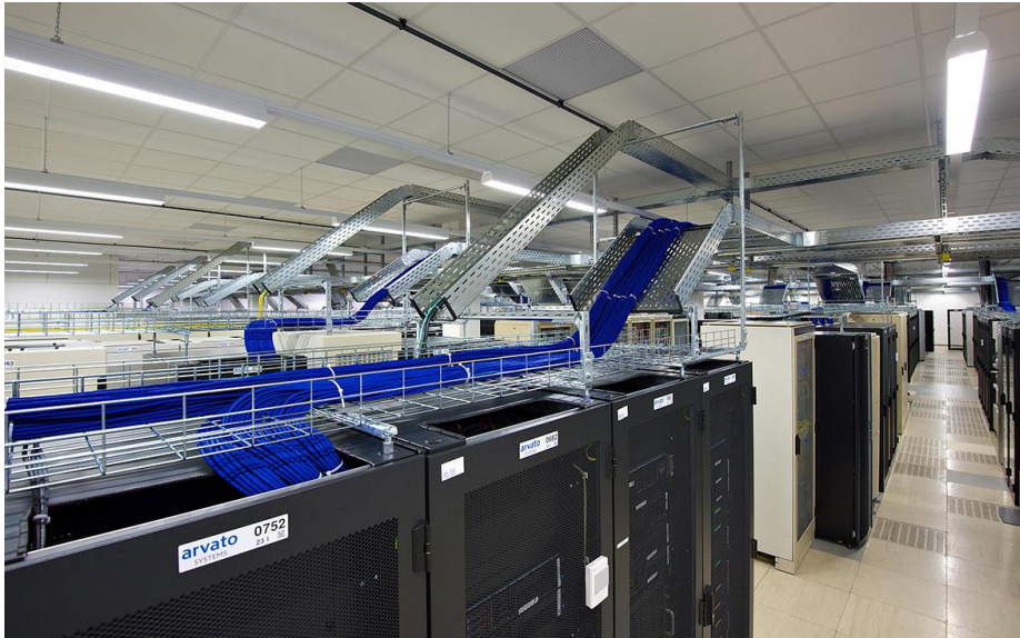
©arvato Systems GmbH : Kabel in Über-Kopf-Trassen
